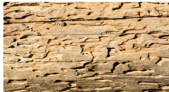
Dégâts causés par des termites dans une charpente
